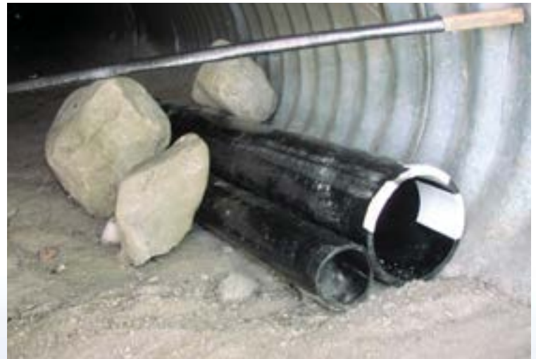
Figura 4. Paso de agua y de fauna silvestre inferior de doble propósito
